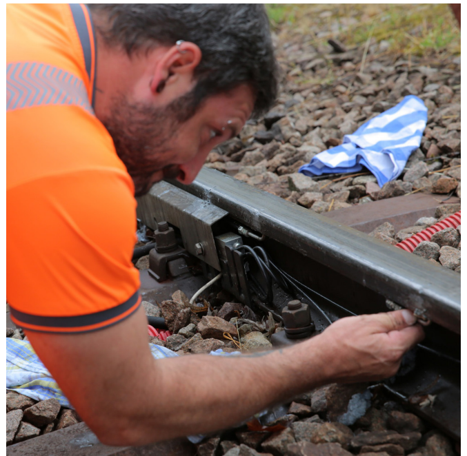
Der Spezialist von Innolutions verlegt eine Schmierleitung zum Schmierpunkt.
