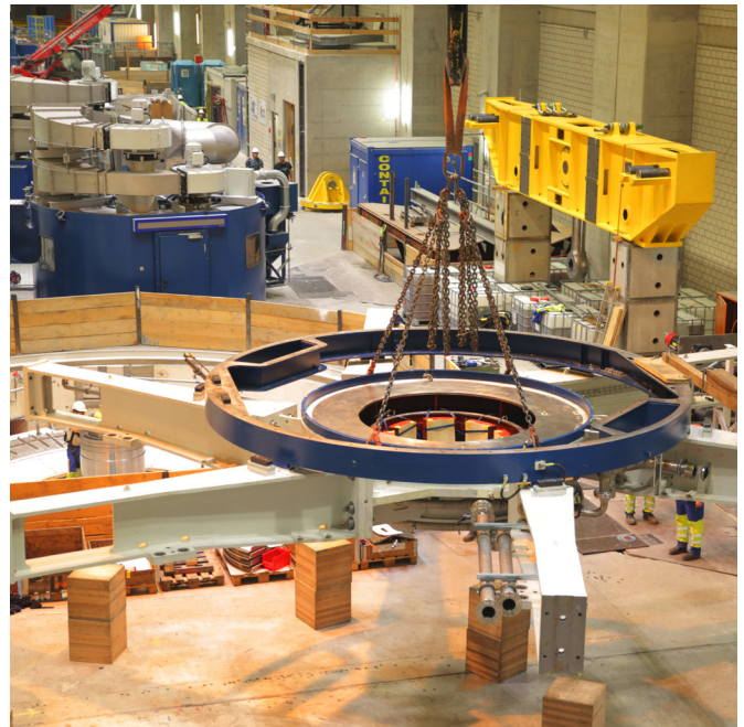
Montage- und Inbetriebsetzungsarbeiten liefen parallel auf der Baustelle unter Tage – eine besondere Herausforderung für die IBS-Leitung.
